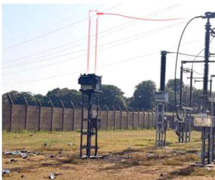
Squididan 225kV- en rouge le TCT soufflé par l'explosion
